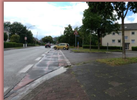
Abgenutzte Markierung und schlechte Oberfläche (Wittdorfer Str.)
