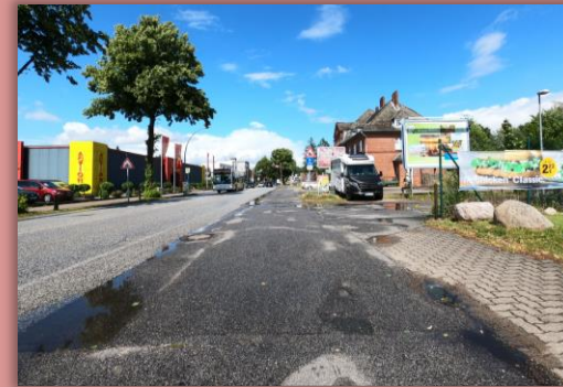
Fehlende Abgrenzung des Wegs und schlechte Oberfläche (Altonaer Str.)
